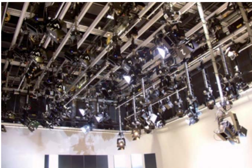
Deckensystem mit Laufschielen, Leuchtenhängern und Scheinwerfern
