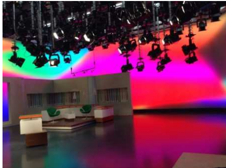
Studio A des SWR Stuttgart mit automatisierter Lichttechnik und LED-Hintergrundbeleuchtung
