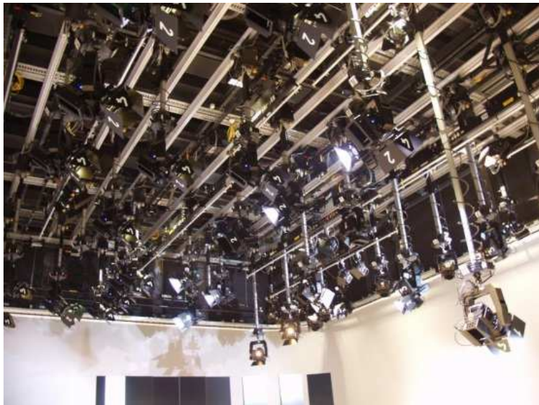
Deckensystem mit Laufschiene, Leuchtenhängern und Scheinwerfern
